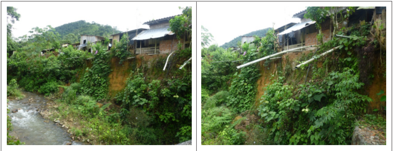
Figura 3. Asentamientos construidos a lo largo de la quebrada Yantzaza que están en riesgo de inundaciones y deslizamientos
